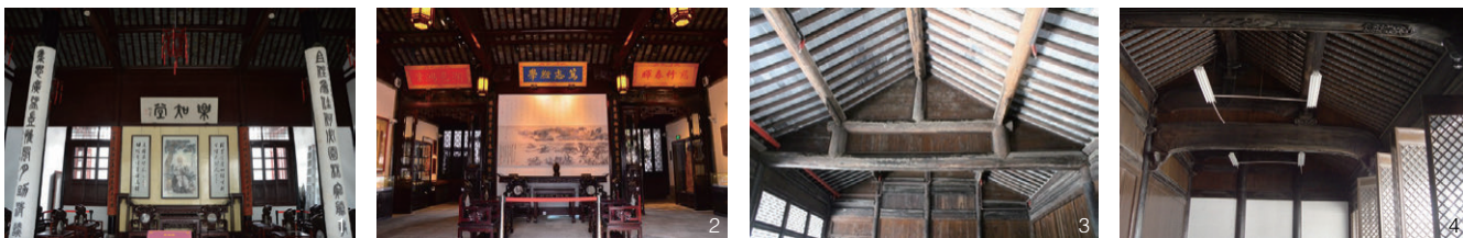
1. 俞樾故居乐知堂圆堂屋架 2. 潘世恩故居鸳鸯厅扁作厅屋架 3. 吕官府大厅圆堂屋架 4. 藤花旧馆楠木厅扁作厅屋架
