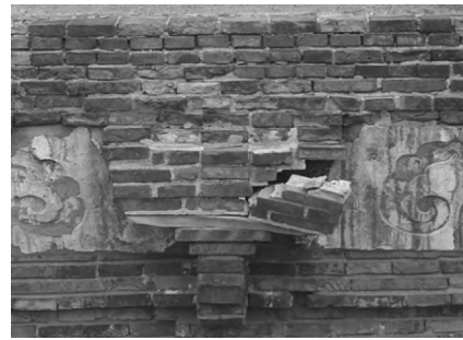
图2 虎丘塔斗拱掉落情况
